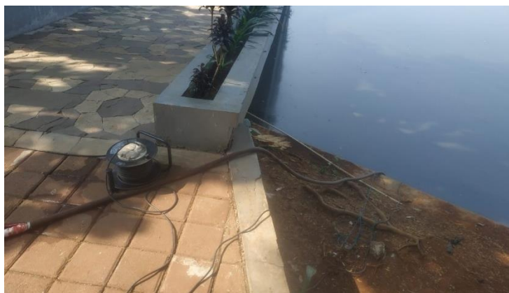
Gambar 6. Pompa air yang berasal dari danau untuk pengairan taman
